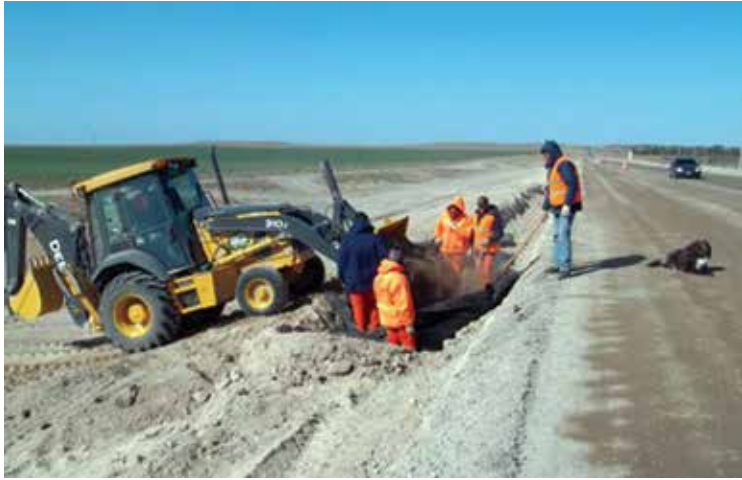
Defensa contra inundaciones Ruta 3, km920 - Buenos Aires
