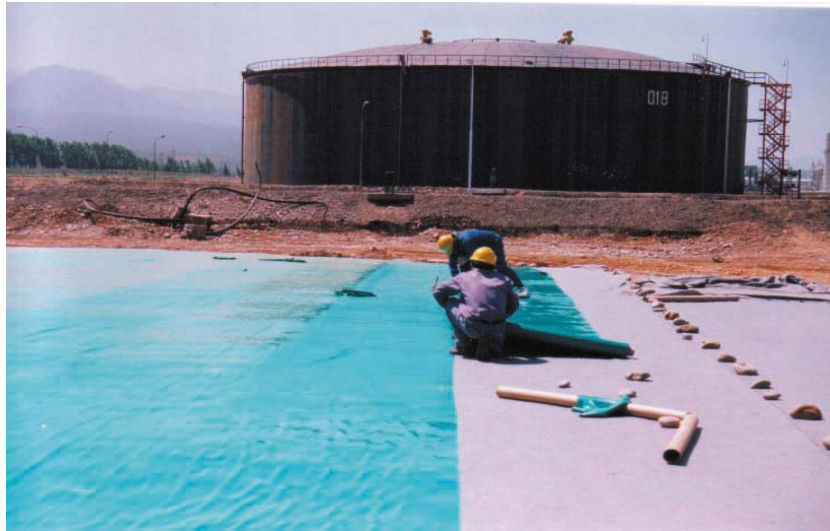
TANQUES DE COMBUSTIBLES – YPF - LUJÁN DE CUYO, MENDOZA
