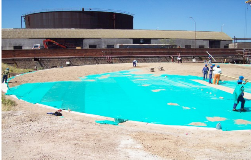
TANQUES DE COMBUSTIBLES – ANCAP – MONTEVIDEO - URUGUAY
