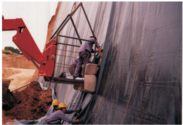
Foto 4: Detalle de la instalación vertical.
