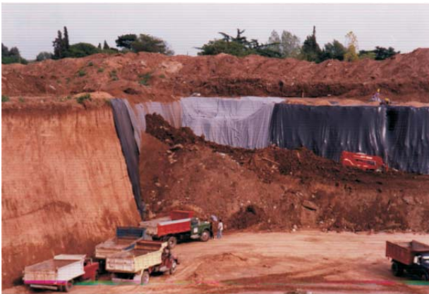
Foto 5: Disposición de residuos industriales en el sector de la fosa ya impermeabilizado.
