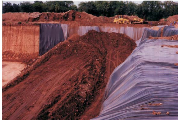
Foto 6: Detalle de residuos industriales depositados en la fosa.
