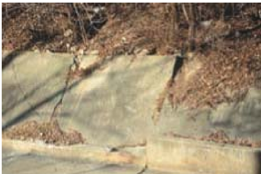
Típicas roturas de las losas rígidas de hormigón
