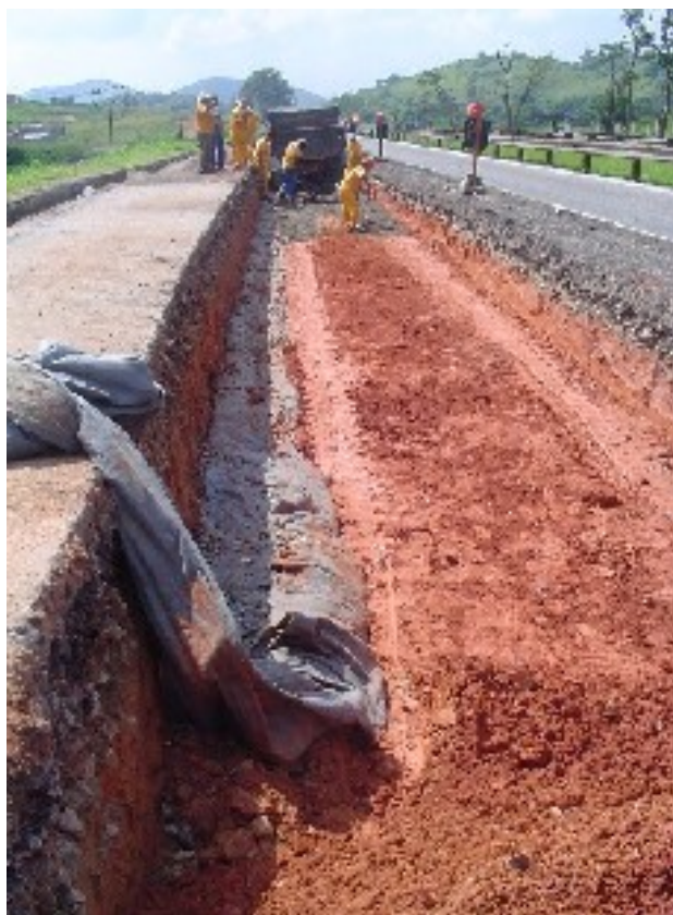
Figura 05 – Detalhe do dreno lateral a pista.
