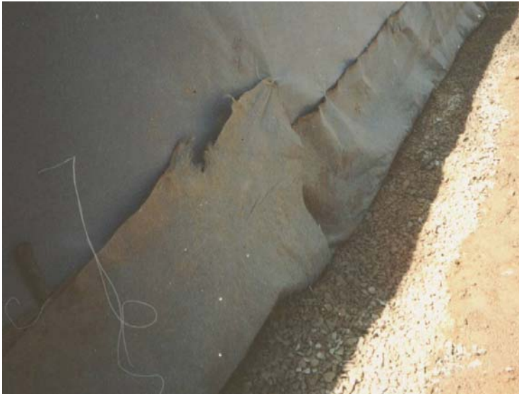
Costura do geotêxtil e brita entre o Bidim e o enrocamento de jusante.
