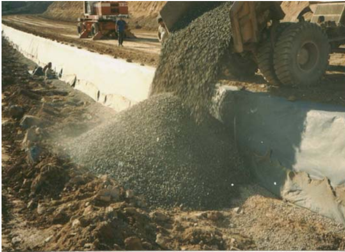
Lançamento da brita 2 do filtro de transição de jusante. Ao fundo operários executam a costura.
