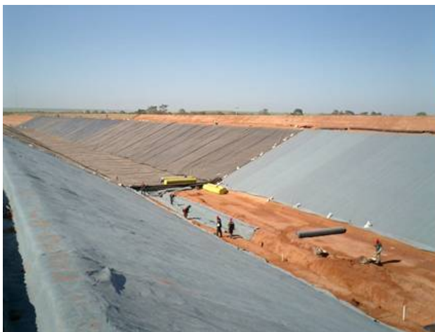
Vista geral da execução da trincheira, notando-se o Bidim para proteção da geomembrana nos taludes e a geomembrana instalada ao fundo.
