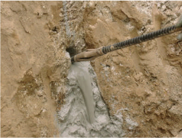
Inserção do grampo injetado (diâmetro 100mm); barra de aço Diwidag ST50/55 – 32mm.
