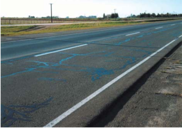
Foto 1: Pavimento existente previo al fresado. Nótese el grado de fisuración del mismo.
