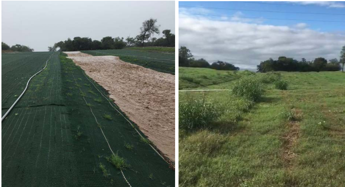
Figura 7.- Fotografía de la solución en servicio antes (izq.) y después (der.) de vegetado.
