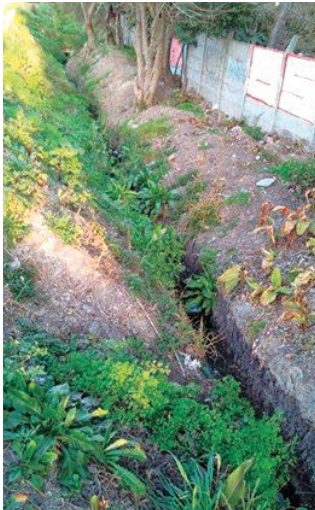
Estado inicial del canal de desagüe
