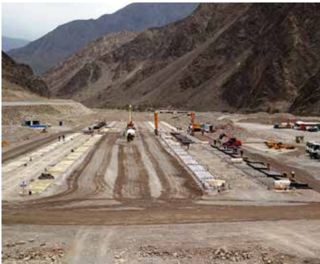
Planta de premoldeado (en Obrador)
