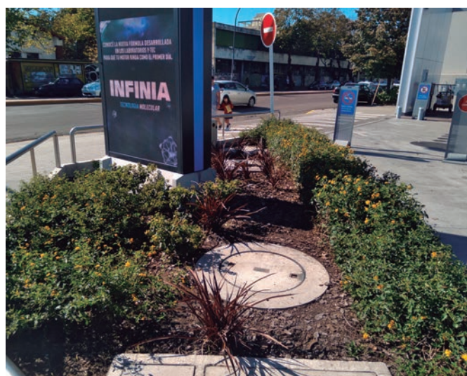
Vista de separador de hidrocarburos ACO Oleopass instalado
