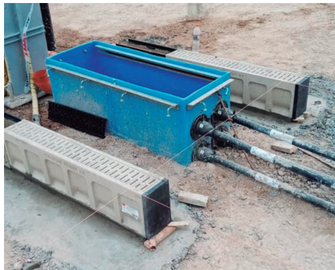
Instalación Monoblock en zona surtidores
