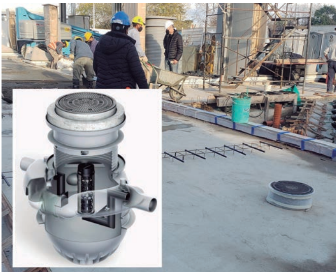
Instalación separador de hidrocarburos
