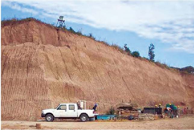
Estado de la barranca previo al perfilado.
