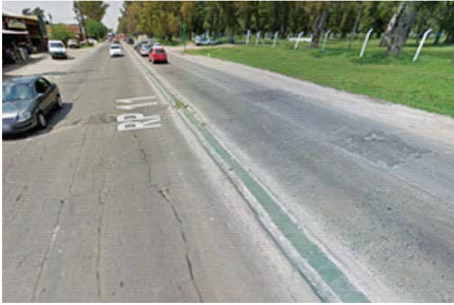
Estado inicial de la calzada de hormigón
