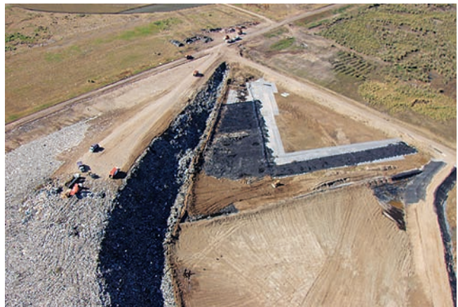
Vista general. A la izquierda celda en funcionamiento. A la derecha ampliaciones en ejecución.
