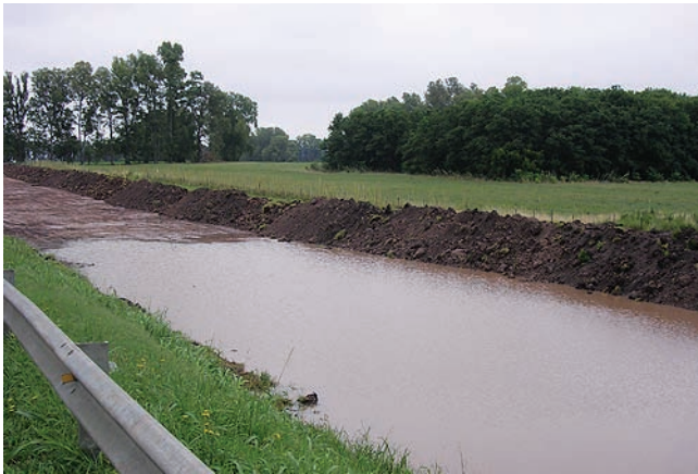
Estado inicial de la fundación del terraplén.
