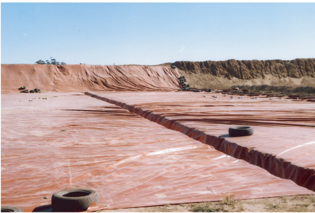
Trinchera drenante para recolección de lixiviados.
