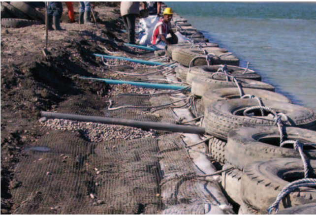
Vista de Geogrilla Fortrac® y defensa de neumáticos
