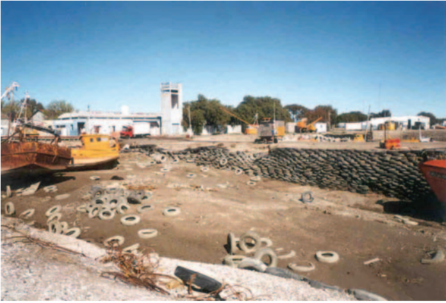
Situación Previa. Desmoronamiento parcial de taludes
