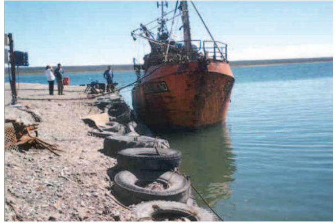
Situación Previa. Deterioro avanzado de cara vista
